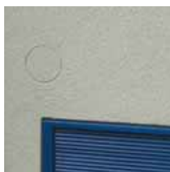
Acceso para cables BT de grupo electrógeno.
